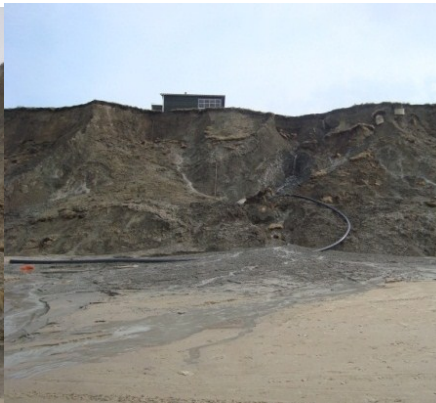
Erosion grundet skadet nedløb (eget foto april 2010)
